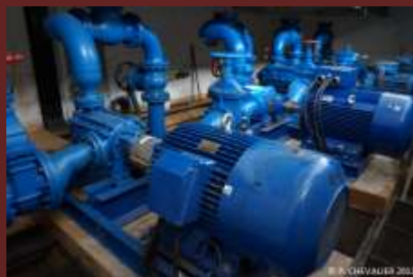
Illustration 51 : Canal du Caïre (à gauche) et pompes de l'ASA du canal du caïre (à droite)
