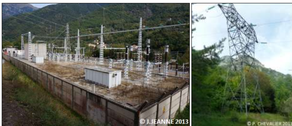
Illustration 52 : poste de transformation RTE (gauche) et pylône relié à des lignes très haute tension (à droite), jouxtant la centrale hydroélectrique de Roquebillière
