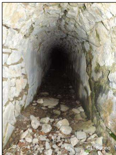
Illustration 31 : Tunnel du canal du Caïre : site d'estivage du Murin à oreilles échancrées
